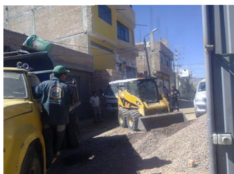
Decomiso de materiales de construcción de la vía pública sin autorización, que afectan la seguridad
