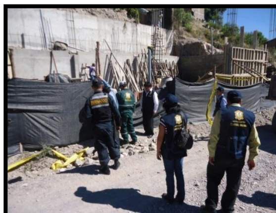
Intervención de obra y decomiso de materiales por construcción en zona de riesgo
