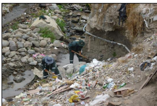
Quebrada vía de evitamiento Contaminado con residuos sólidos, desmontes, material aluvial
