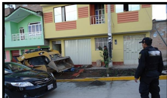
Eliminación de Rampa Antirreglamentaria
